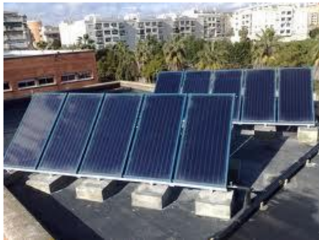
Placas solares fotovoltaicas
